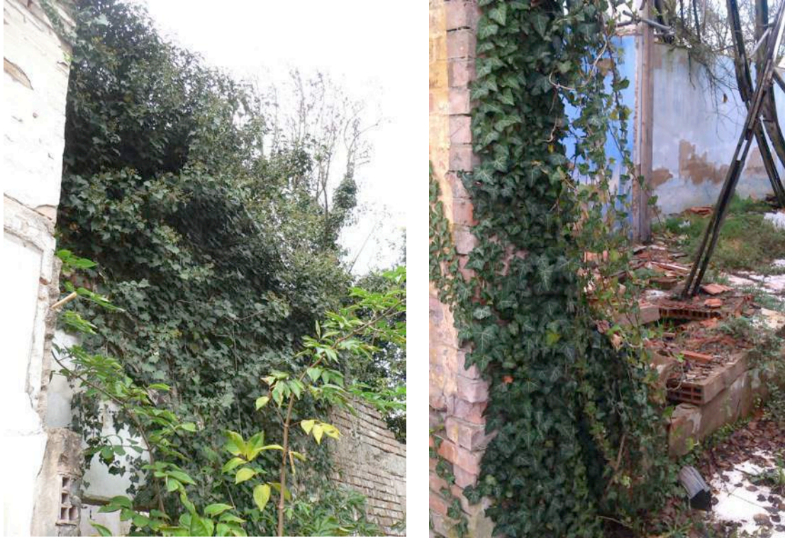
Figura 0-2 Paramenti murari interessati dalla presenza di Hedera helix (vista 10 e 11)
