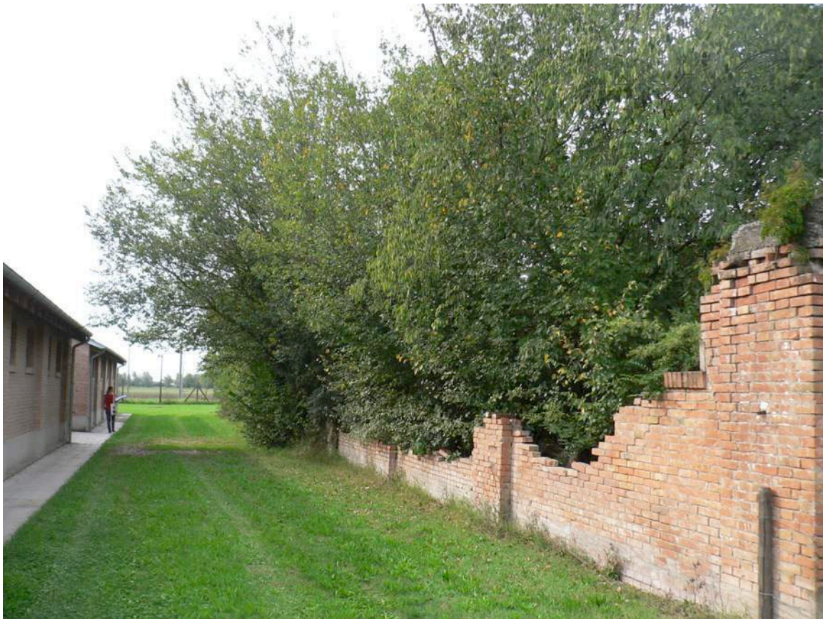
Figura 2-5 Processo spontaneo di rinaturalizzazione dell'edificio n. 14.2: la vegetazione arborea è costituita in prevalenza da Ulmus minor e Prunus sp. , con presenza di Robinia pseudoacacia e Celtis australis .
