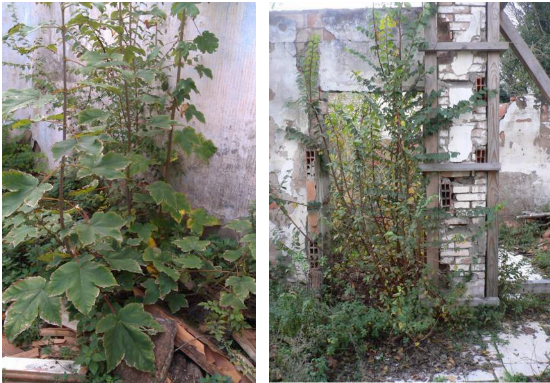
Figura 3-5 Lo sviluppo di specie arbustive ad elevato indice di pericolosità nelle vicinanze delle murature e alla base di pilastri. Nella foto a sinistra Acer pseudoplatanus (vista 3), a destra un esemplare di Ulmus minor (vista 4).
