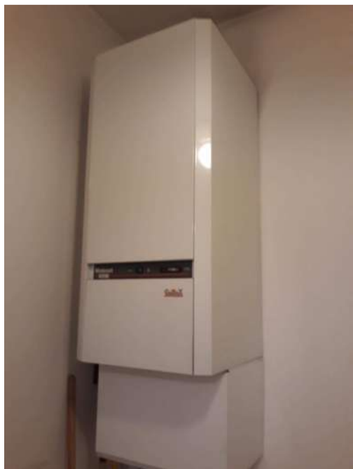
RIPOSTIGLIO: TERMINALE RISCALDAMENTO E ACQUA CALDA SANITARIA
