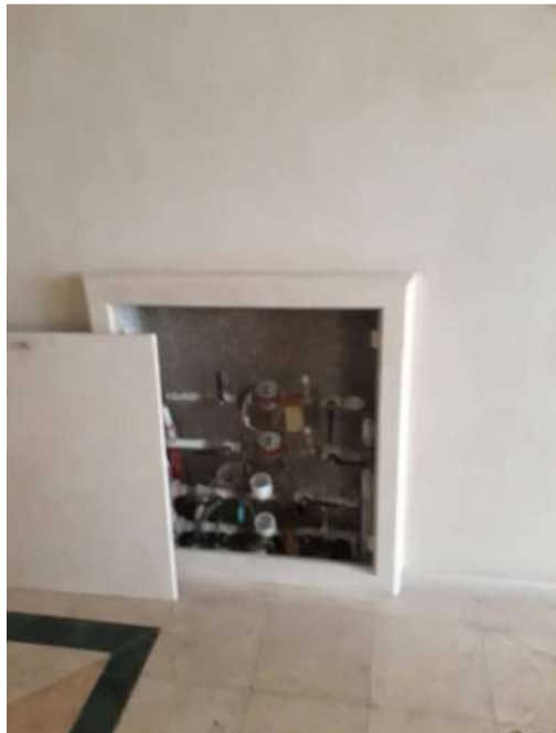
INGRESSO CONDOMINIALE COLLETTORE
