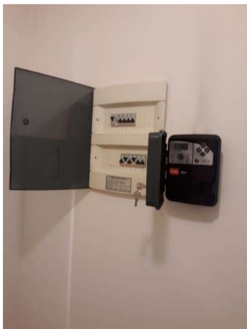
RIPOSTIGLIO: QUADRO ELETTRICO E CENTRALINA IRRIGAZIONE
